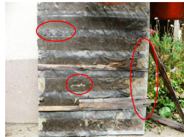
写真7 全体的に著しく脆化し、剥離しつつある防水紙
