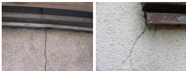
写真 1 モルタルのひび割れ状態 (5 物件とも類似の状態を確認)
