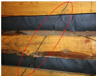
写真6 モルタルのひび割れとともに破損した防水紙
